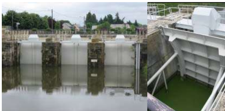
Figure 4.5 : Photographies des vannes automatiques du Pont Bourguignon (les Ponts-de-Cé)
