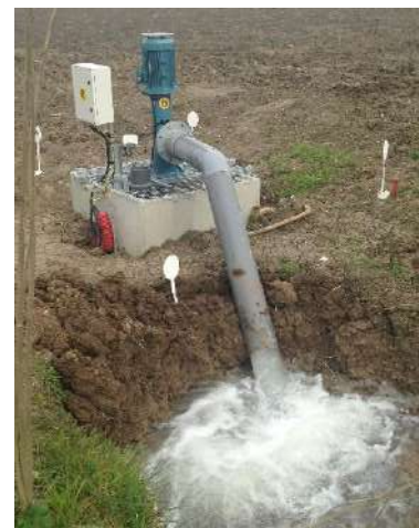
Figure 5: Pompe de refoulement d'un collecteur de drains agricoles
